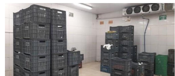
Помещение с системой кондиционирования воздуха для хранения продукции после упаковки перед отгрузкой
