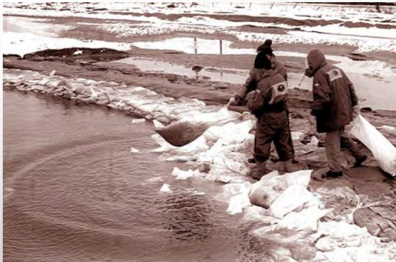
Рис. 5. Рабочие пытаются перекрыть прорыв мешками с песком (источник: Ecomagazin.ro)
