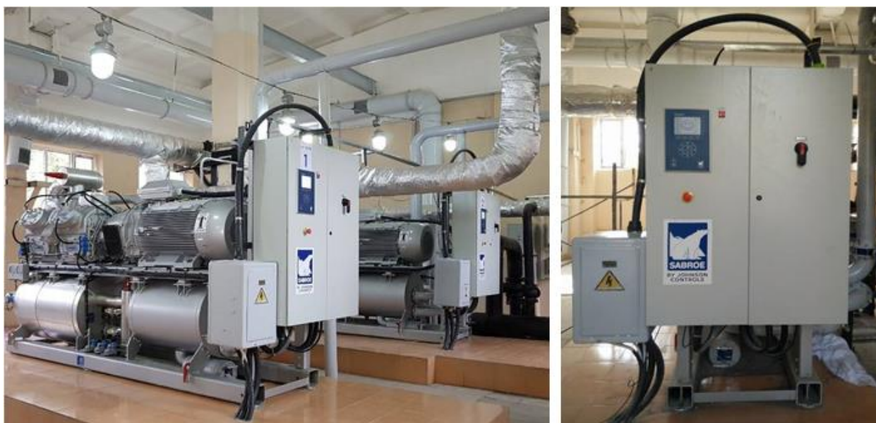
Рисунок 9. Общий вид нового чиллера, работающего на R717
