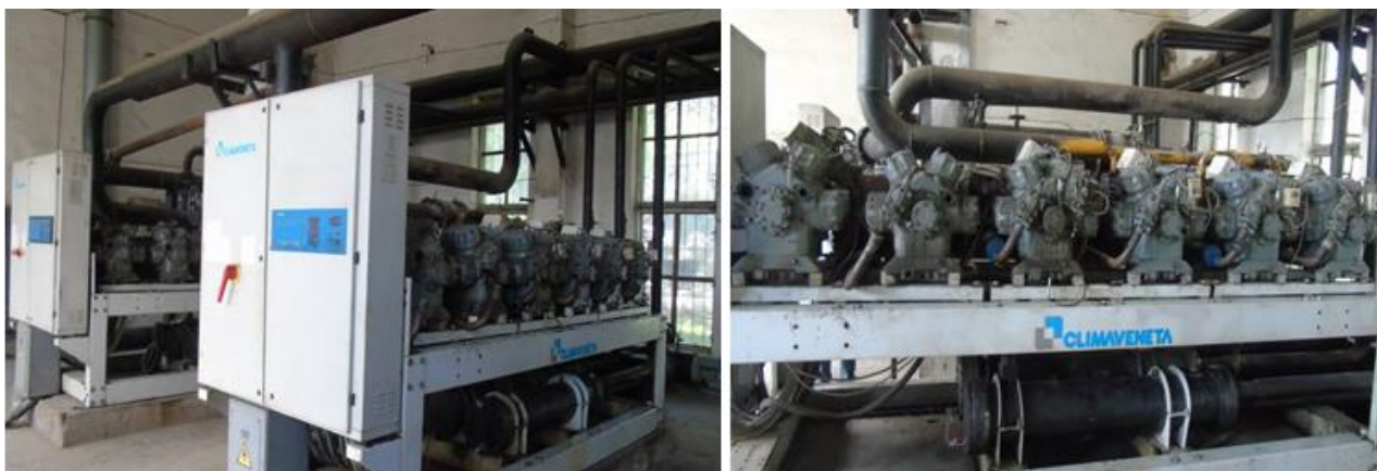
Рисунок 8. Общий вид устаревшего чиллера, работающего на R22
