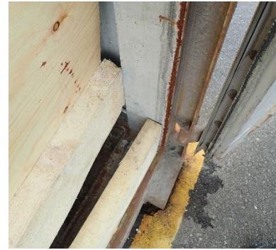
Figure 7.73 Poutres trop courtes
