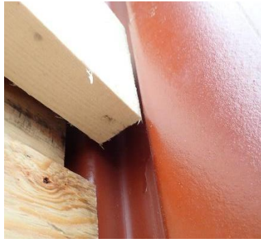
Figure 7.72 Poutre trop courte
