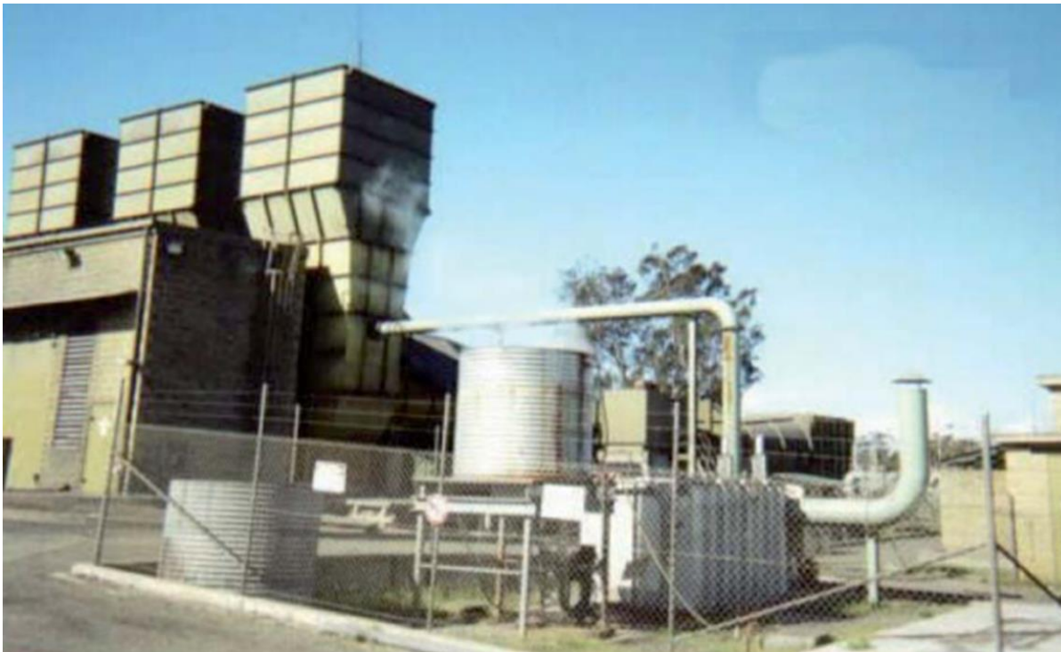
Instalacja Vocsidizer w kopalni Appin, Australia
