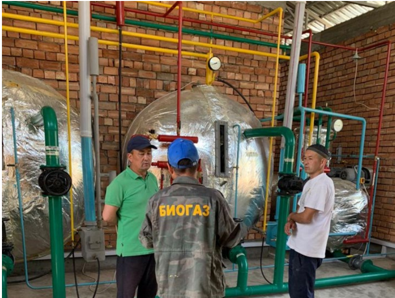
Реакторы биогазовой установки
