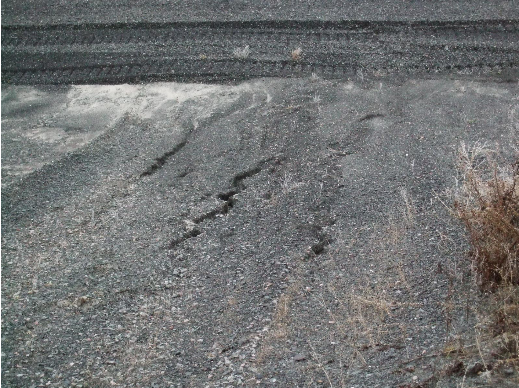
Внешний откос дамбы хвостохранилища: дождевые промоины. В этих местах могут возникнуть овраги
