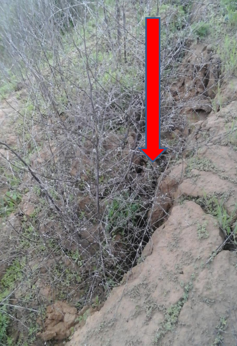
Внешний борт дамбы хвостохранилища. Трещина отрыва оползня
