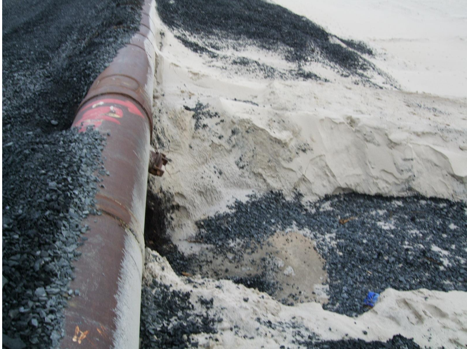
Внутренний откос дамбы хвостохранилища. Размыв вследствие утечек из шламовых труб
