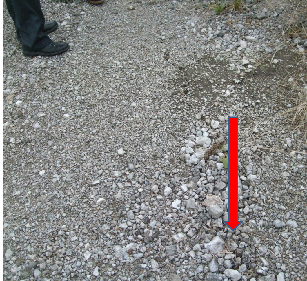
Гребень дамбы хвостохранилища. Трещина отрыва на – неявный признак зарождающегося оползня
