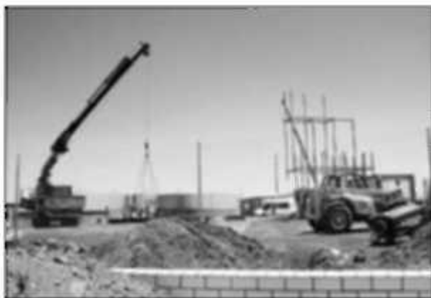
Máquinas trabajan en la construcción de la alcoholera que Viñaoliva está levantando en la carretera Foto: J. C.
